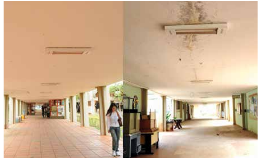
Alguns trechos apresentaram vazamentos, outros não
