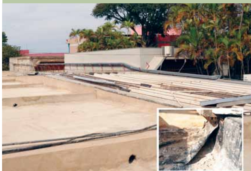
As coberturas estão sendo refeitas. No detalhe, como estava a antiga manta
